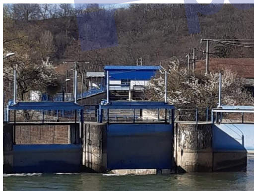
Foto Microhidrocentrală Cetățeni
