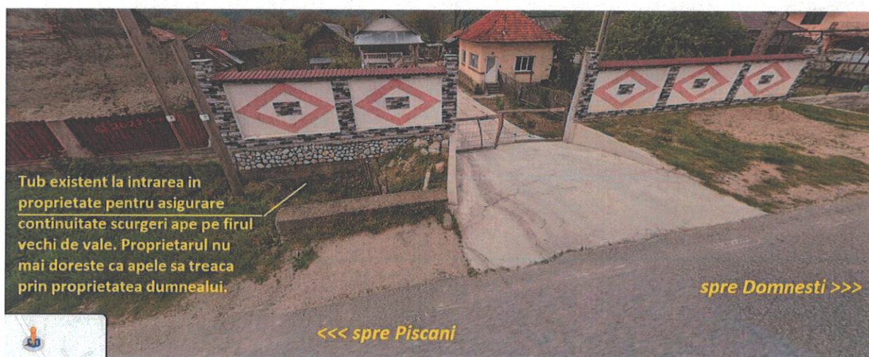
Vedere podet existent km13+500 – partea stanga – timpan zona deversare + zona de scurgere
